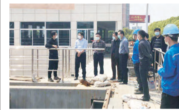
本报讯：4月7日上午，市城发集团党委书记、董事长谈国华，总经理程正栋，副总经理石兰田到公司花湖水厂实地查看二期工程进度，公司领导余曦、张昌锐等参加。谈国华详细询问了前期工作情况、工程施工进度和施工难点，要求切实抓好工程质量与安全管理，严格责任落实，确保二期项目的顺利进行。(郑莹)
